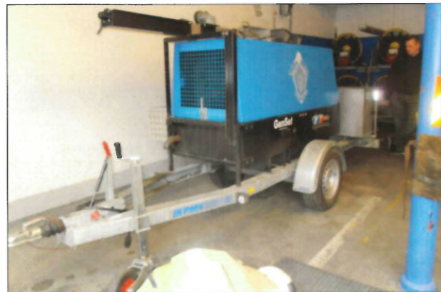
... nødstrømsgenerator til brug i Metroen ... Foto: TFR
